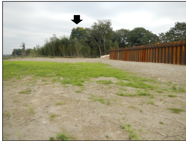
図-11 破堤箇所と隣接する樹林。手前の鋼矢板がある場所が破堤箇所
