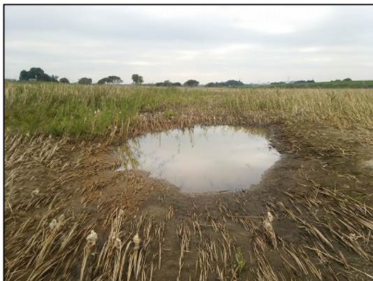
図-9 破堤箇所付近に生じていた凹地
