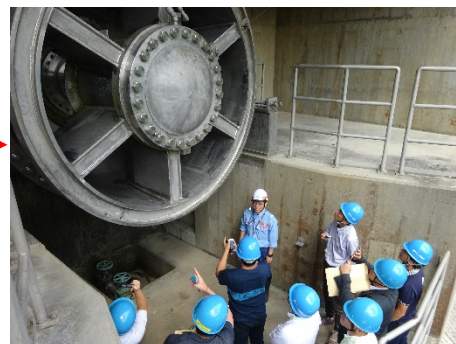
中位標高放流設備
