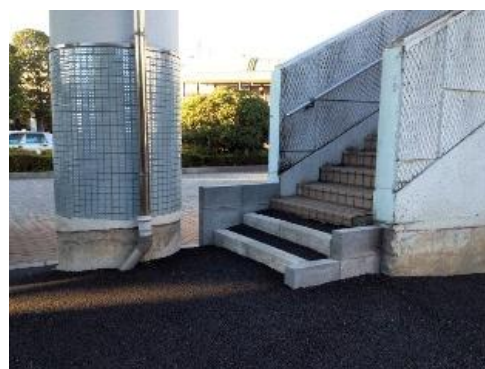
液状化現象で段差の生じた浦安駅前の階段
